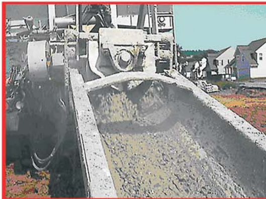
El hormigón sale del transportador del bisenfín y entra en el canal de descarga
